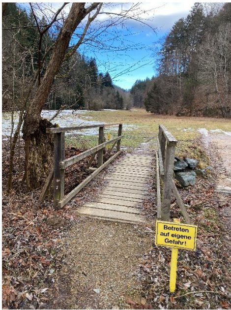
Holzbrücke mit Beschilderung „Betreten auf eigene Gefahr“
